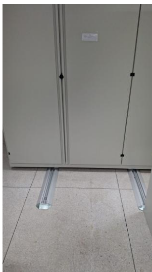
Foto 1 — portas com fechadura e trilhos de alumínio direto no piso.
