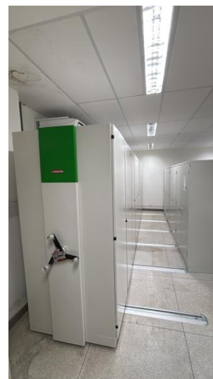
Foto 3 — corredor com trilhos; infiltração no forro acima do conjunto.
