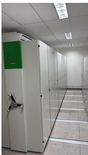
Foto 4 — equipamento de ar-condicionado sobre o módulo de extremidade.
